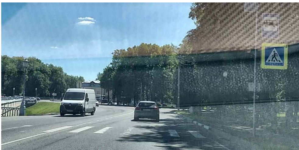
Рисунок 2.6.2.1 – Отсутствует разметка 1.17.1 согласно требованиям ГОСТ Р 52289-2019, ООТ «Красноармейский проспект»
